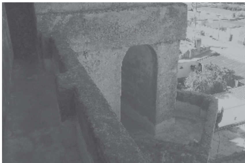
Figura 19 (1), (2) y (3). Detalles de las cajas de agua de los contrafuertes del templo del convento de Tepeaca
