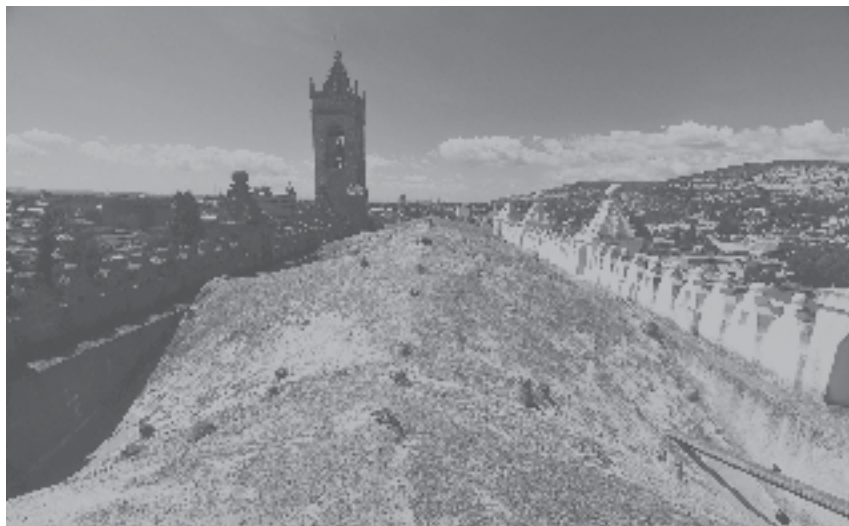
Figura 15. Bóvedas de la cubierta del convento de Tepeaca Fuente: fotografía de Adriana Dávila. Archivo propiedad del autor.
