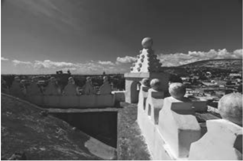
Figura 20. Garita superior noroeste de la cubierta del templo del convento de Tepeaca Fuente: fotografía de Adriana Dávila. Archivo propiedad del autor.
